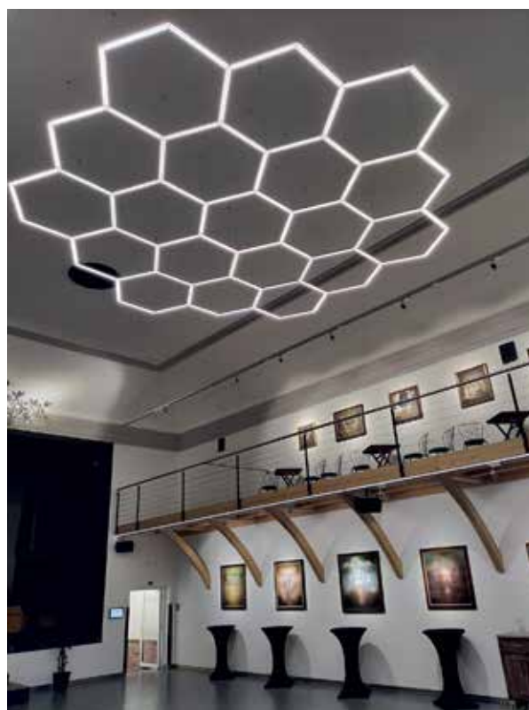
Světelnou dominantou velkého sálu je objekt u stropu sestavený ze stmívatelných šestiúhelníků; zdroj: archiv CBA.
