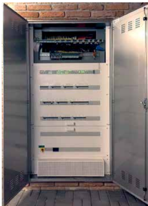
Podružný rozvaděč pro řízení osvětlení v suterénu; v horní řadě svítí zelené indikátory výstupních relé a stmívačů periferií Foxtrot, ve stejném rozvaděči jsou sdruženy všechny jisticí a chránící přístroje silové elektroinstalace; zdroj: archiv CBA.
